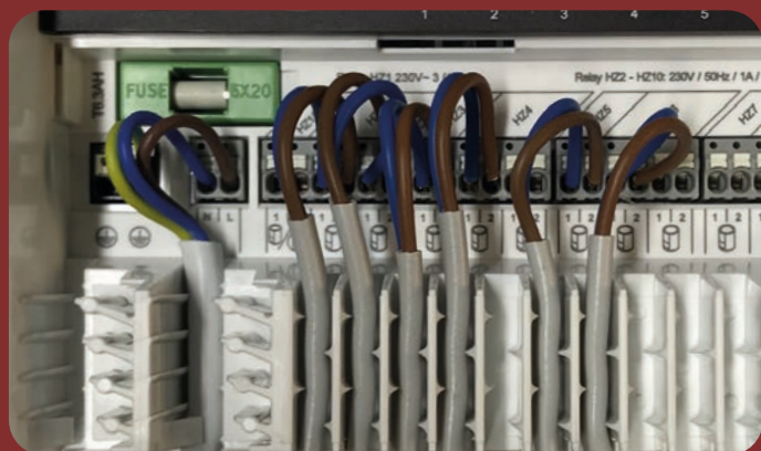
- telestaterne er ledningsført til styreboksen
