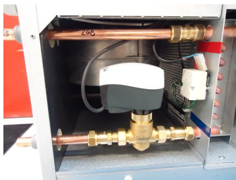
Frosttermostat monteret på eftervarmeblade
